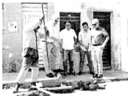
O presidente da Cagece, Nauri Freitas, acompanhando os trabalhos na contensão de vazamentos no bairro Pici, em Juazeiro do Norte.
